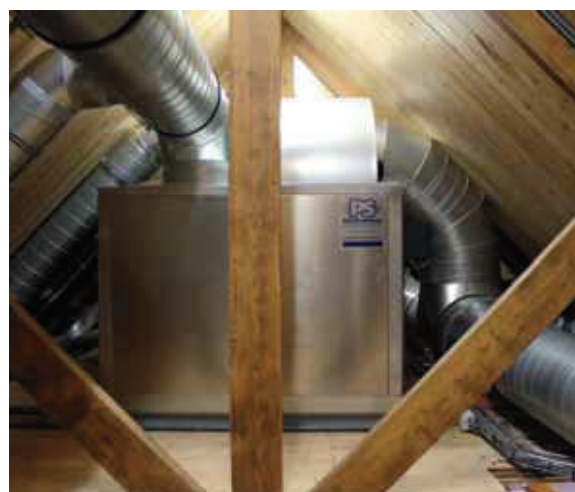
Luchtbehandelingskast, opgebouwd uit RVS-panelen.
