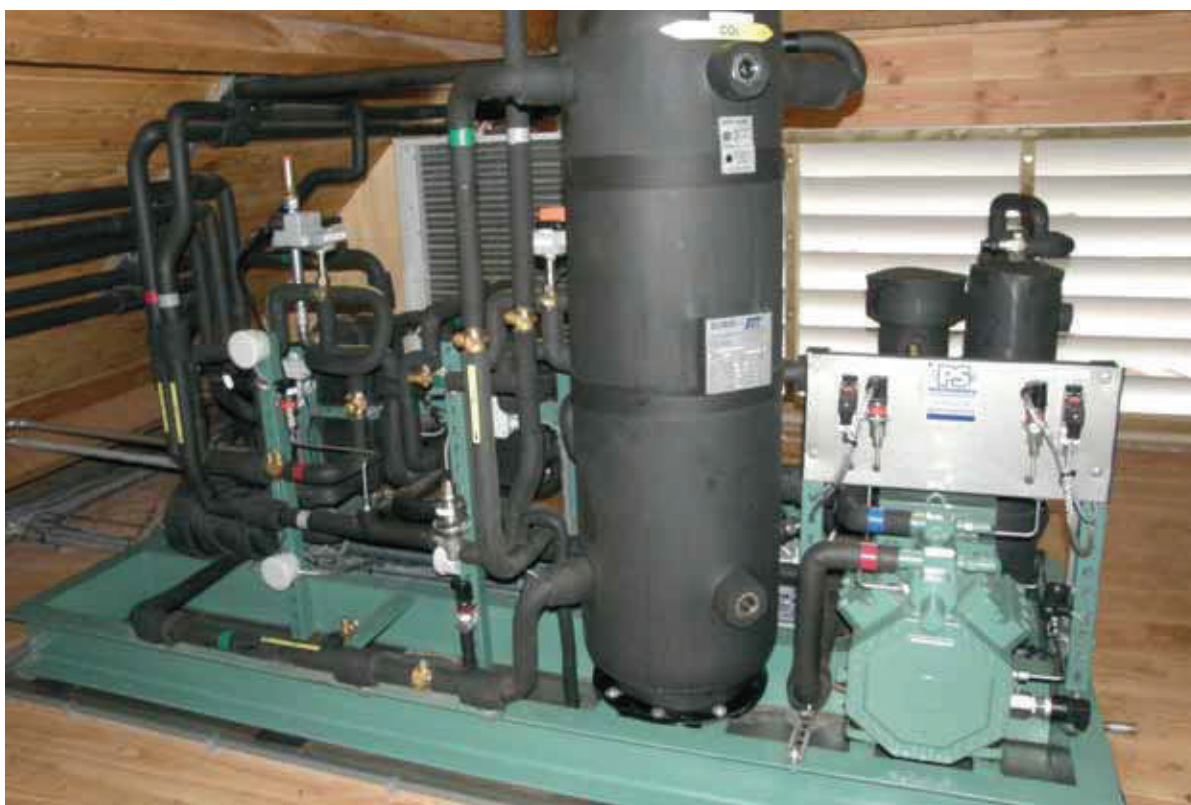
De compact samengebouwde CO 2 -installatie met op de achtergrond de gaskoeler.
