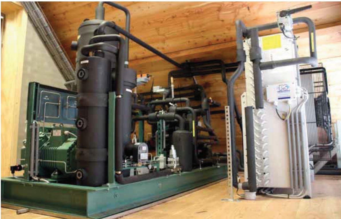
De CO 2 -installatie met rechts de gaskoeler.
